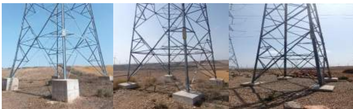
Foto nº19.: Estado general de los apoyos. Ejemplo del Apoyo nº 17, Apoyo nº 18 y Apoyo nº 23 de la LAAT.
