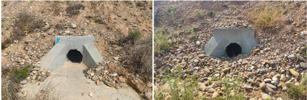
Foto nº44.: T-08: Drenaje del vial.
