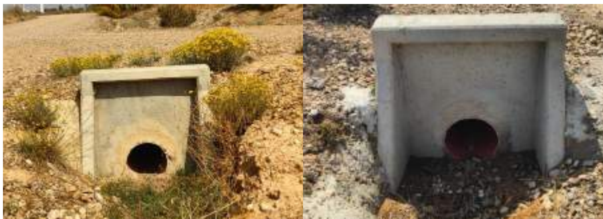
Foto nº47.: T-14: Drenaje del vial.
