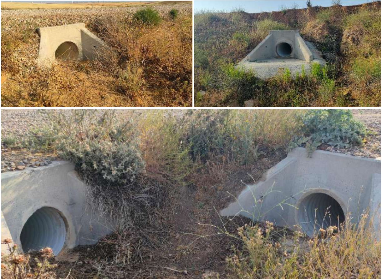
Foto nº48.: Drenaje de vial de acceso al PE.
