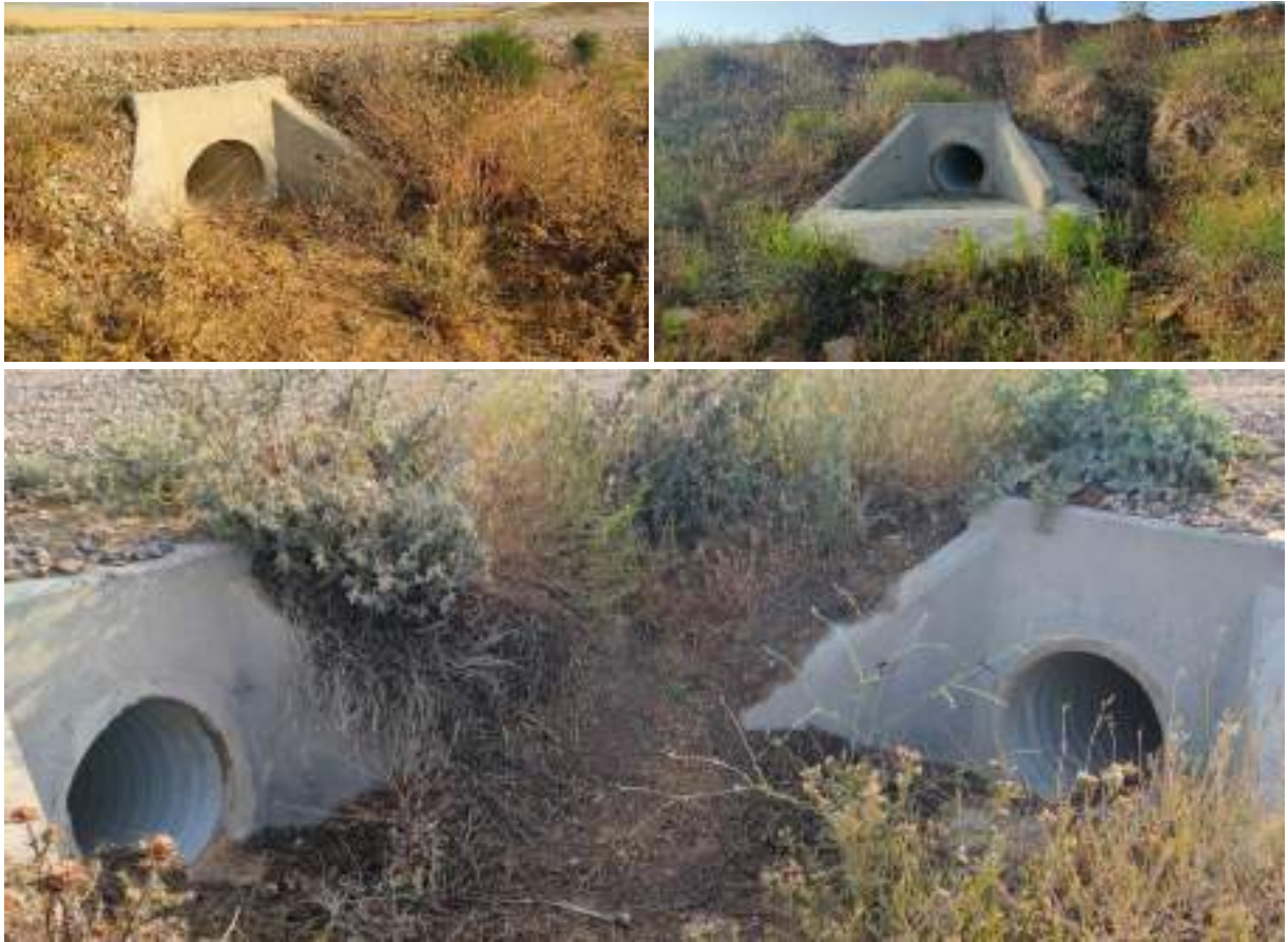
Foto nº48.: Drenaje de vial de acceso al PE.
