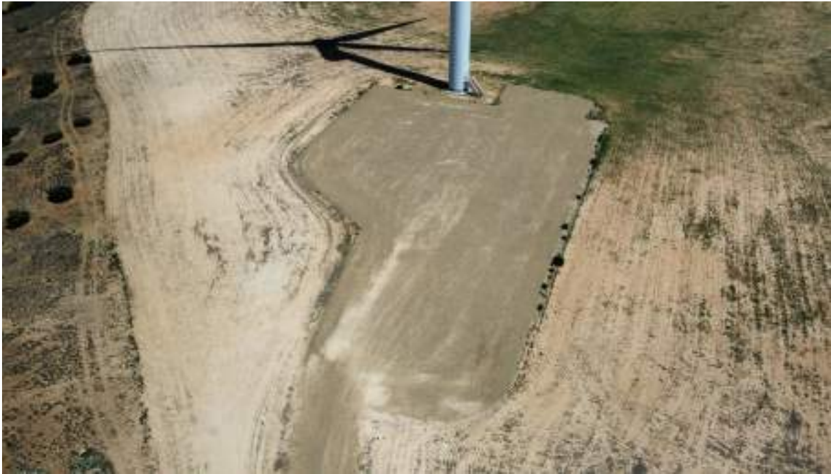
Foto nº3.: Plataforma del Aerogenerador T-03.
