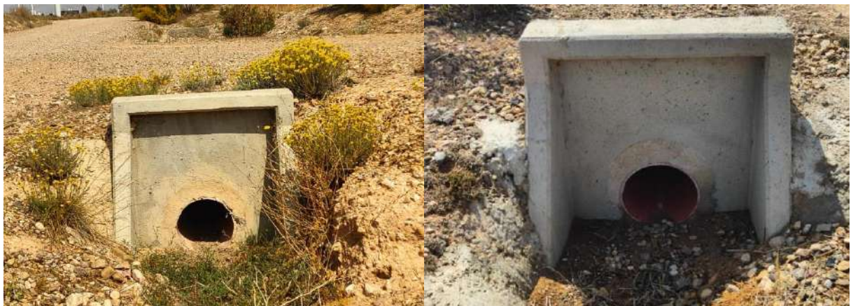
Foto nº47.: T-14: Drenaje del vial.
