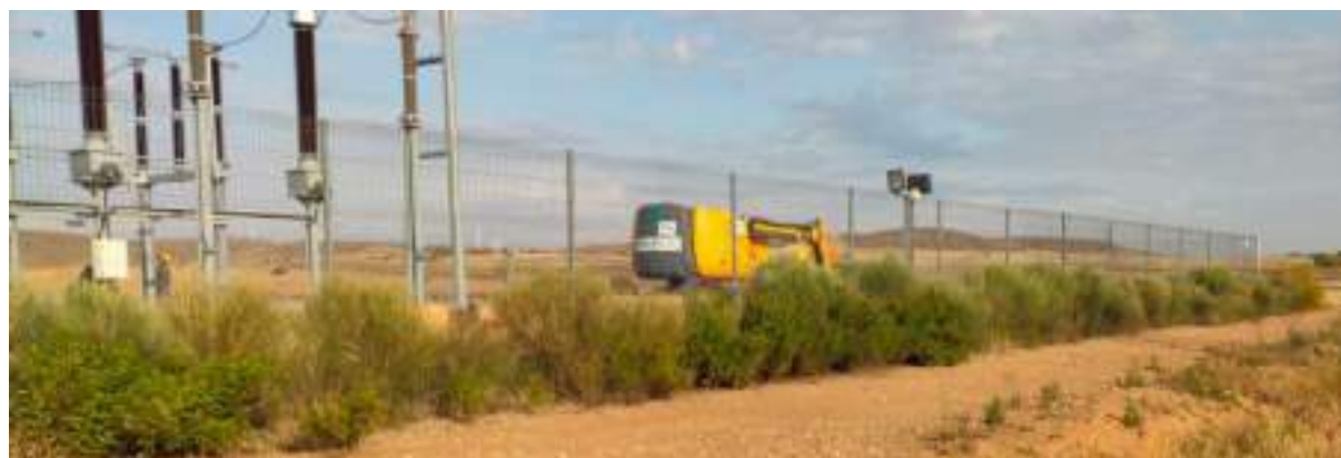
Foto nº36.: Pantalla vegetal de la SET, orientación este.
