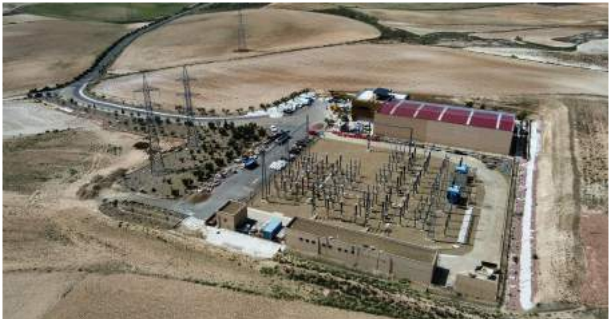
Foto nº21.: SET Bayo. Punto final de la LAAT.
