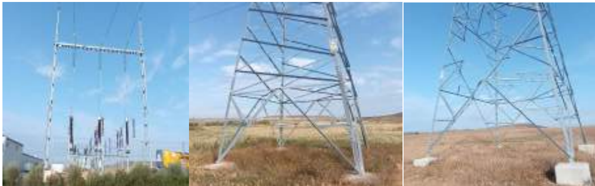
Foto nº16.: Estado general de los apoyos. Ejemplo del Apoyo nº 1 y nº 2 de la LAAT.
