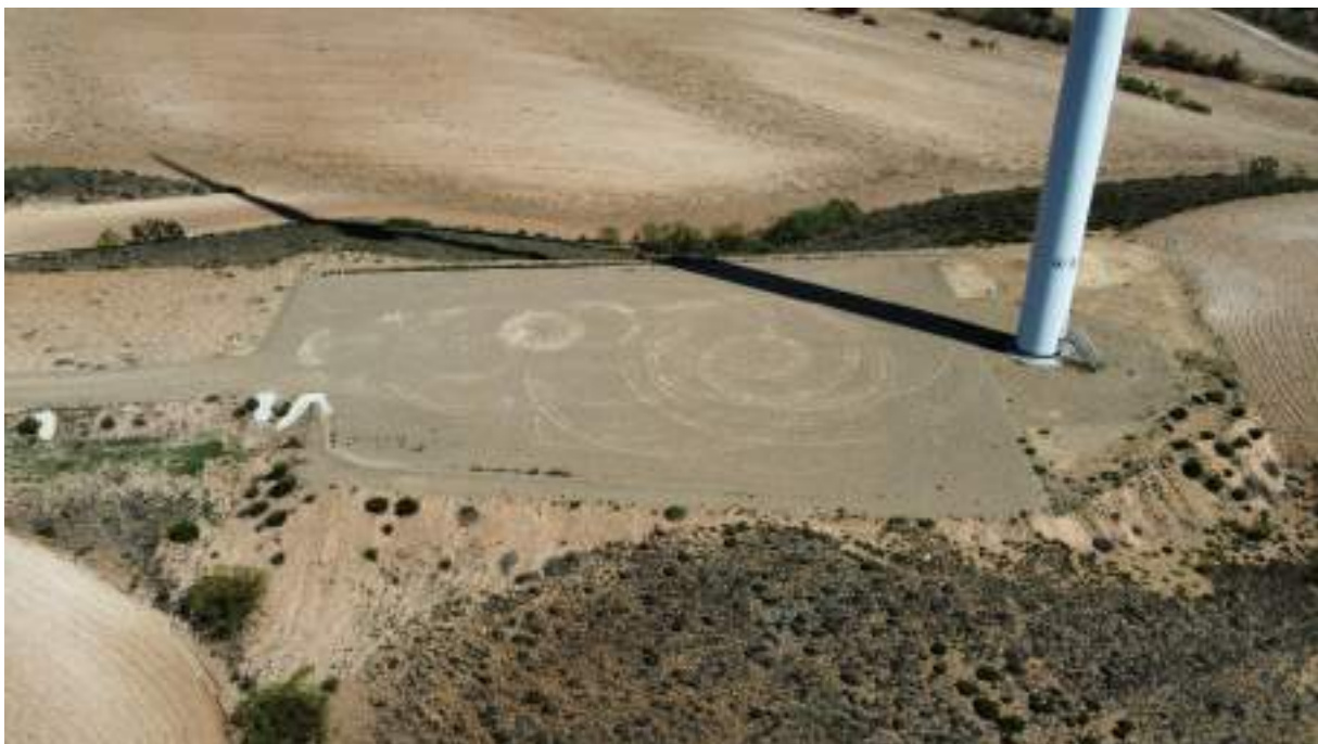
Foto nº14.: Plataforma del Aerogenerador T-14.
