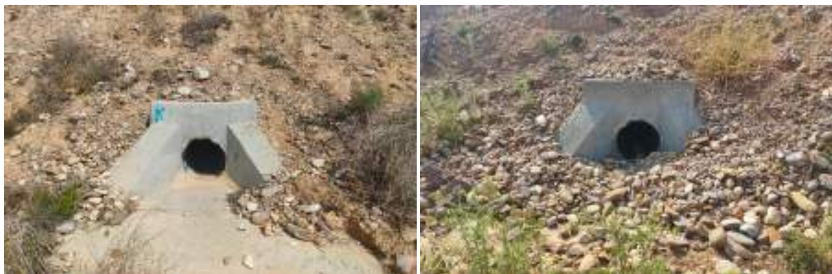
Foto nº44.: T-08: Drenaje del vial.
