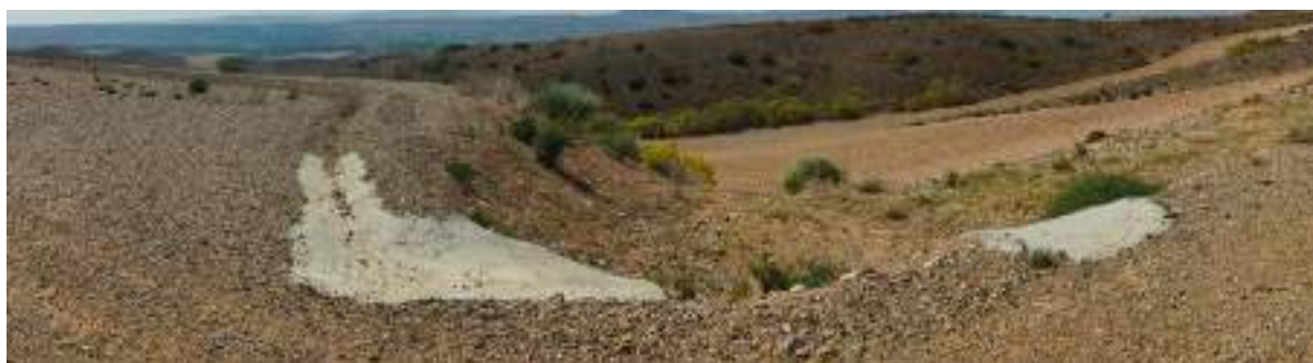
Foto nº46.: T-14: Detalle canalización en plataforma.
