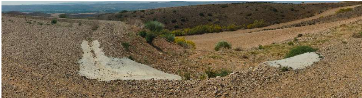
Foto nº46.: T-14: Detalle canalización en plataforma.
